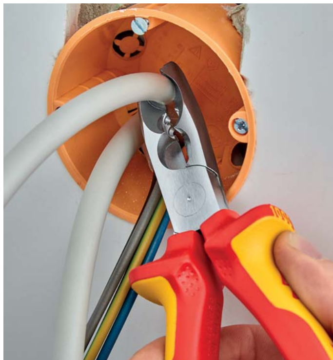
Odizolování hluboko dole v krabici pod omítkou
